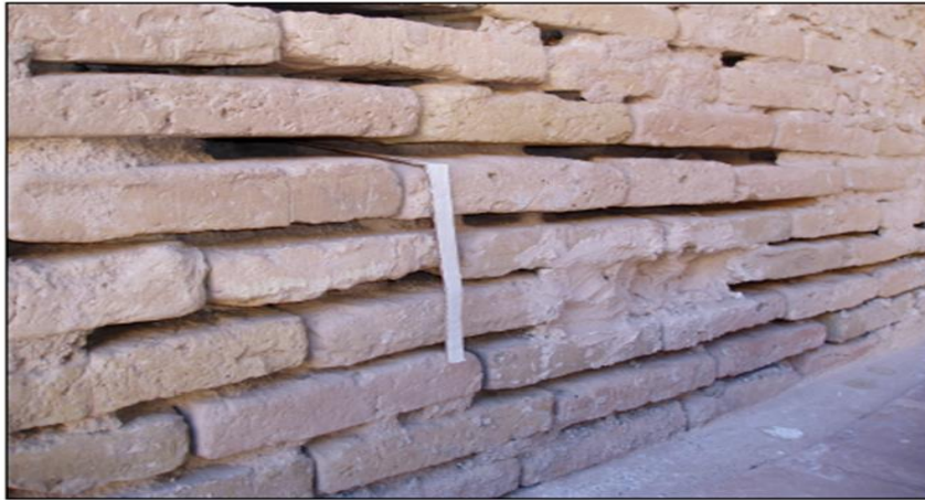
تصویر ۱۳: فرسایش ملاط گچ مابین آجرهای دیواره جنوبی ایوان غربی مدرسه غیاثیه (منبع: نگارنده گان، ۱۳۹۸).
