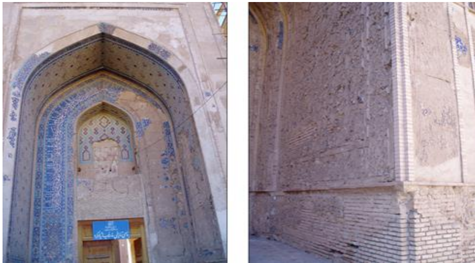
تصویر ۱۰- سمت راست: آسیب‌دیدگی دیواره شمالی ایوان جنوب غربی مدرسه غیاثیه، سمت چپ: آسیب‌دیدگی ایوان شمال شرقی (ورودی اصلی) مدرسه غیاثیه (منبع: نگارنده گان، ۱۳۹۸).
