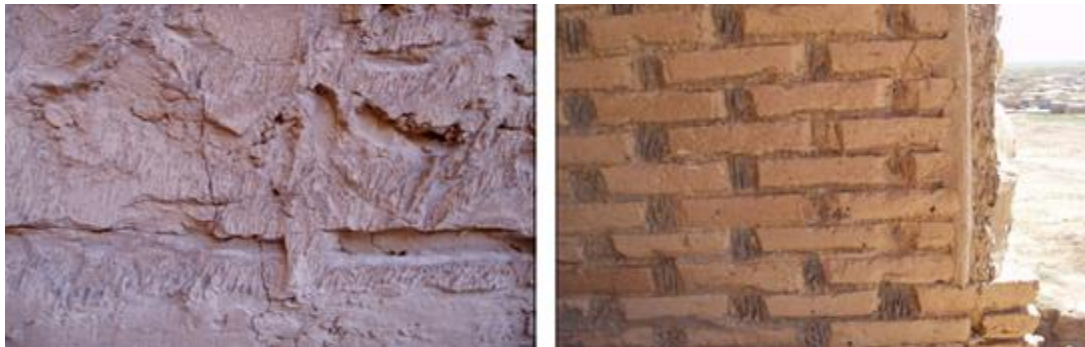
تصویر ۱۲- سمت راست: فرسایش یکی از دیواره‌های ایوان خارجی طبقه فوقانی بنای سلطانیه - سمت چپ: فرسایش دیواره شمالی ایوان جنوب غربی مدرسه غیاثیه (منبع: نگارنده‌گان، ۱۳۹۸).
