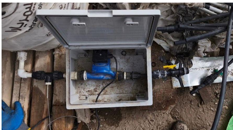
شکل ۲- پمپ سیرکولاتور و نحوه نصب آن در مدار هیدرولیکی
