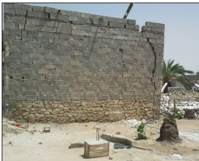
شکل ۱۴- ساختمان‌های بنایی بدون کلاف افقی یا قائم
