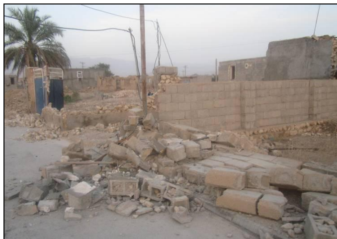
شکل ۱۳- عدم قفل و بست صحیح در گوشه دیوارها
